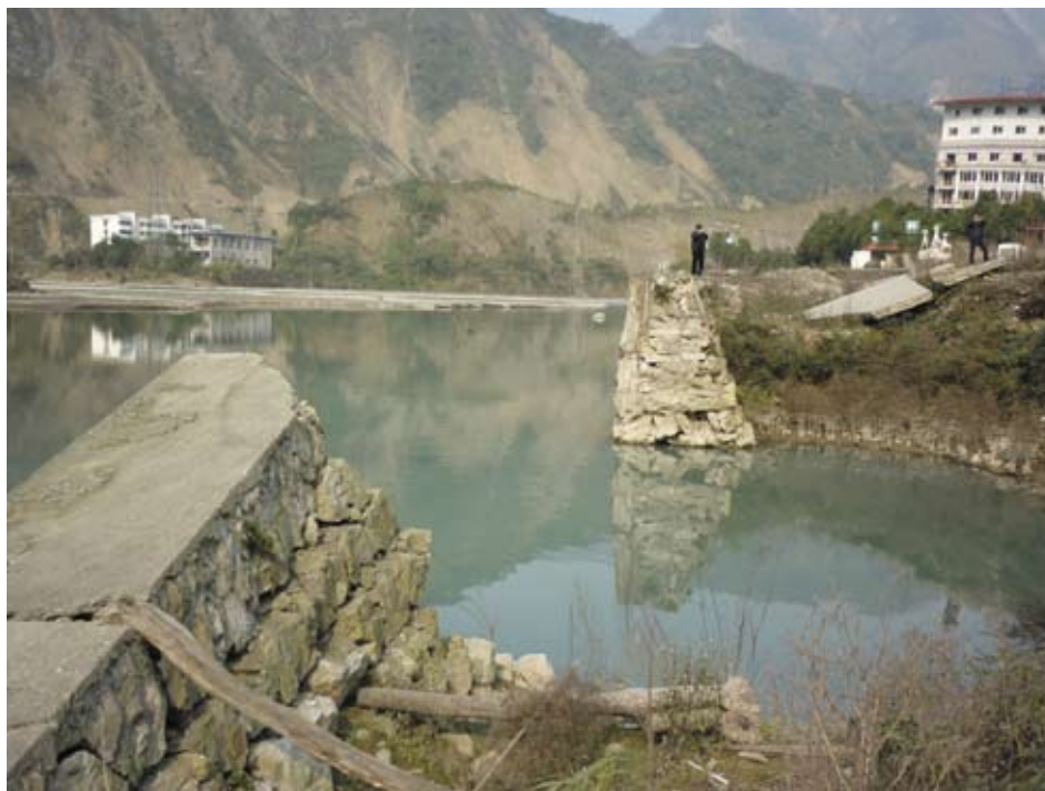
Рис. 11. Взбросо-правосдвиговое смещение набережной (фото автора); на противоположном берегу реки видны многочисленные свежие оползни.
