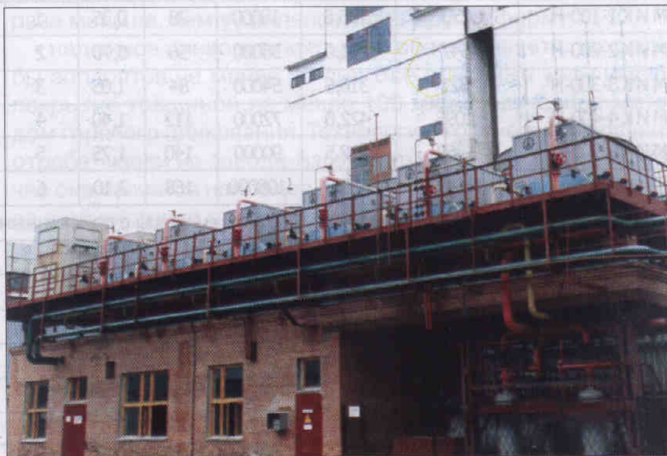
Конденсаторное отделение Ульяновского пивзавода «Витязь», оборудованное шестью испарительными конденсаторами
