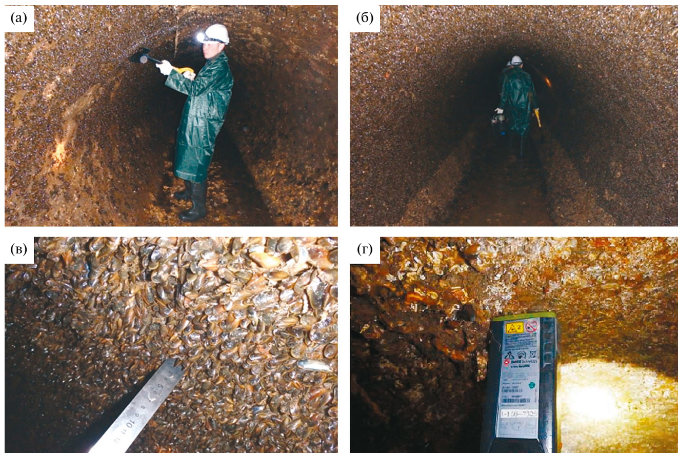
Рис. 2. а, б – процесс пробоотбора микроперифитона в бетонном тоннеле ВТЭЦ-2 на участке с мощным мидиевым обрастанием, в – приближенный фрагмент мидиевого обрастания на поверхности тоннеля, г – лазерный дальномер “Leica DISTO A8” на фоне макрообрастания.
