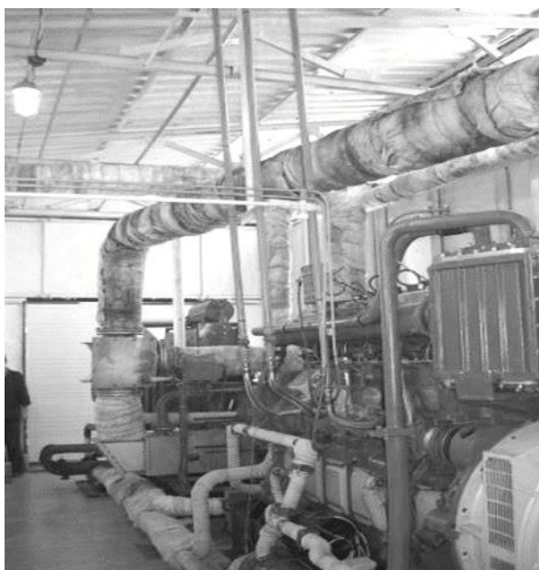
Рис. 3. Общий вид газового двигатель-генератора с блоком утилизации теплоты на объекте эксплуатации.
