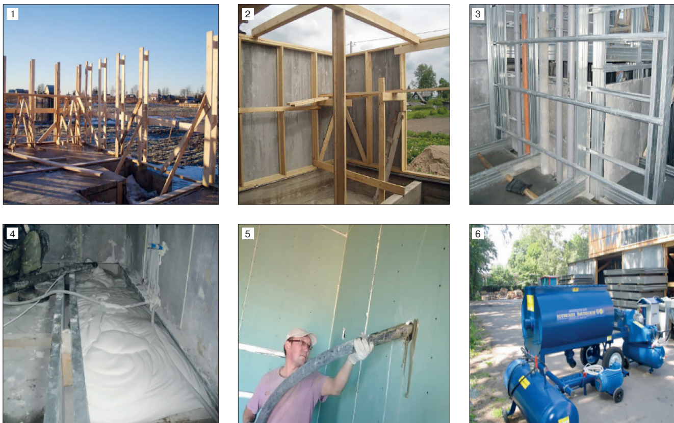
Рис. 2. Этапы строительства малоэтажных каркасных домов по технологии СОВБИ Fig. 2. Stages of construction of low-rise frame houses using SOVBI technology
