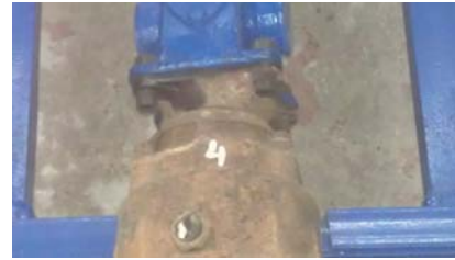
Рис. 5. Место установки вибродатчика на корпусе механизма блокировки
