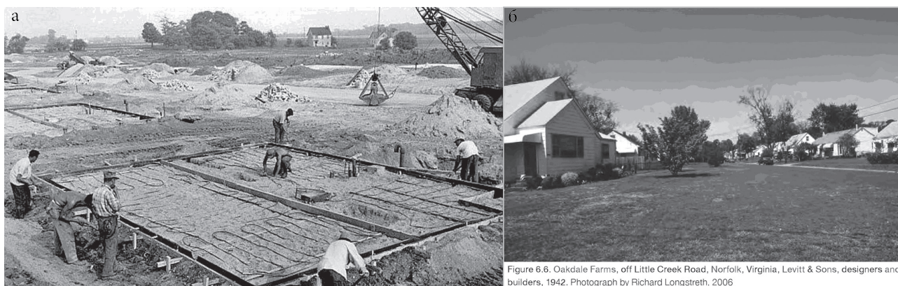
Рис. 10. а) Подготовка к заливке фундамента [24] и дома, б) построенные в Окдейл Фармс (г. Норфолк), в 2006 г. [25].
