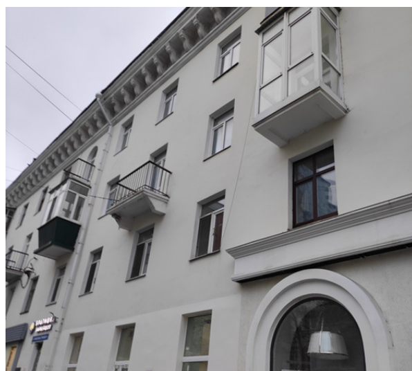
Рис. 2. Под частью балконов отсутствуют декоративные консоли
