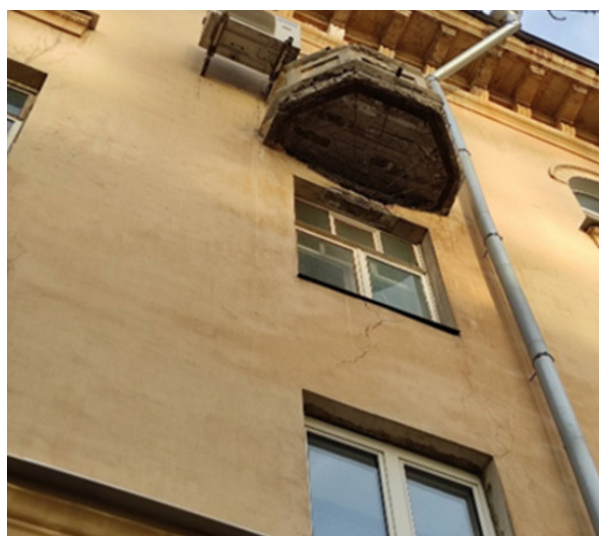
Рис. 1. Декоративный элемент под балконной плитой утрачен. Обнажена арматура балконной плиты
