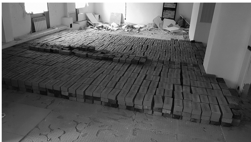
Рис. 9. Испытание № 2. Загруженный полной нагрузкой участок перекрытия (вид со стороны второго этажа)
