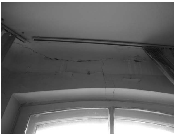
Рис. 7. Трещины в лучковой перемычке. Характерные трещины в штукатурном слое потолка в результате деформации деревянного перекрытия (здание по ул. Некрасовской, д. 38/119)
