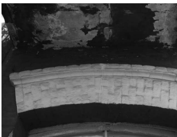
Рис. 5. Кирпичная лучевая перемычка (здание администрации Самарского района по ул. Некрасовской, д. 38/119). Видны трещины в перемычке
