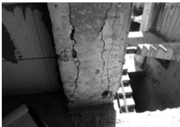
Рис. 4. Вид коррозионного разрушения бетона стены второго этажа по оси 3 продуктами коррозии арматурных стержней незавершенного строительства здания
