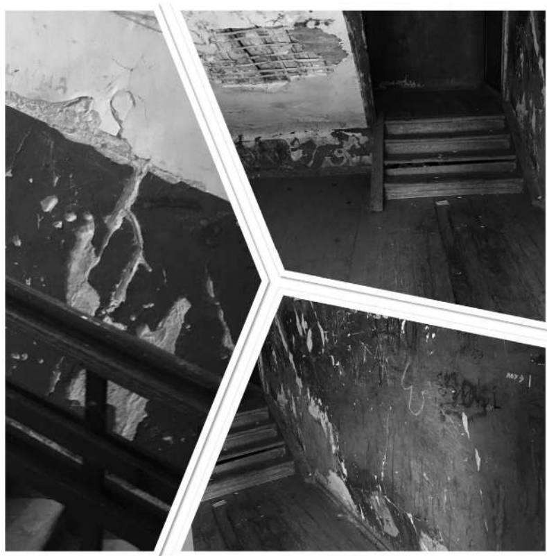
Рис. 6. Состояние оснащения подвезда аварийного здания
