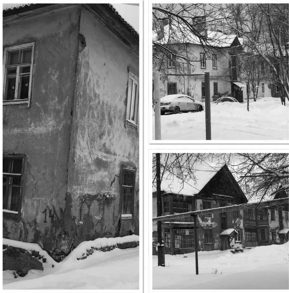
Рис. 4. Аварийные здания по ул. Ветвистой в Красноглинском районе
