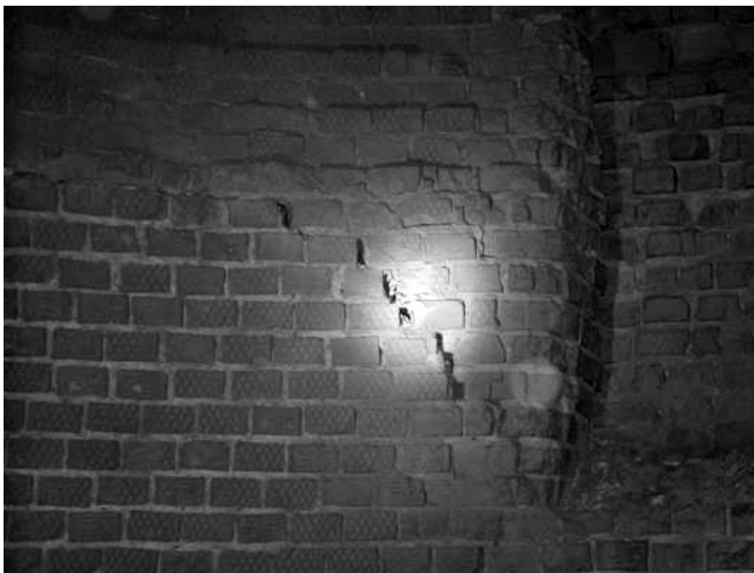
Рис. 2. Разрушение футеровки газоотводящей трубы
