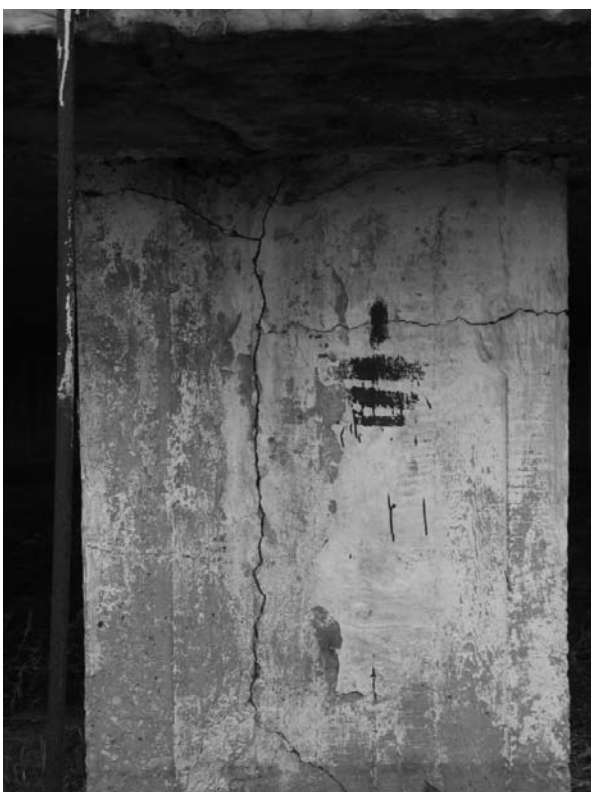
Рис. 3. Вертикальные и наклонные трещины в бетоне стоек
