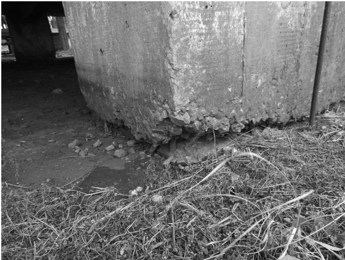
Рис. 4. Химическое и эрозионное повреждение бетона
