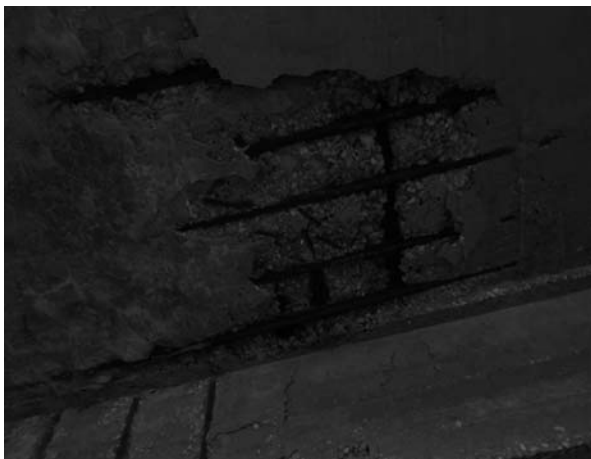
Рис. 2. Разрушение защитного слоя бетона, оголение и коррозия арматуры на нижней поверхности плит перекрытия
