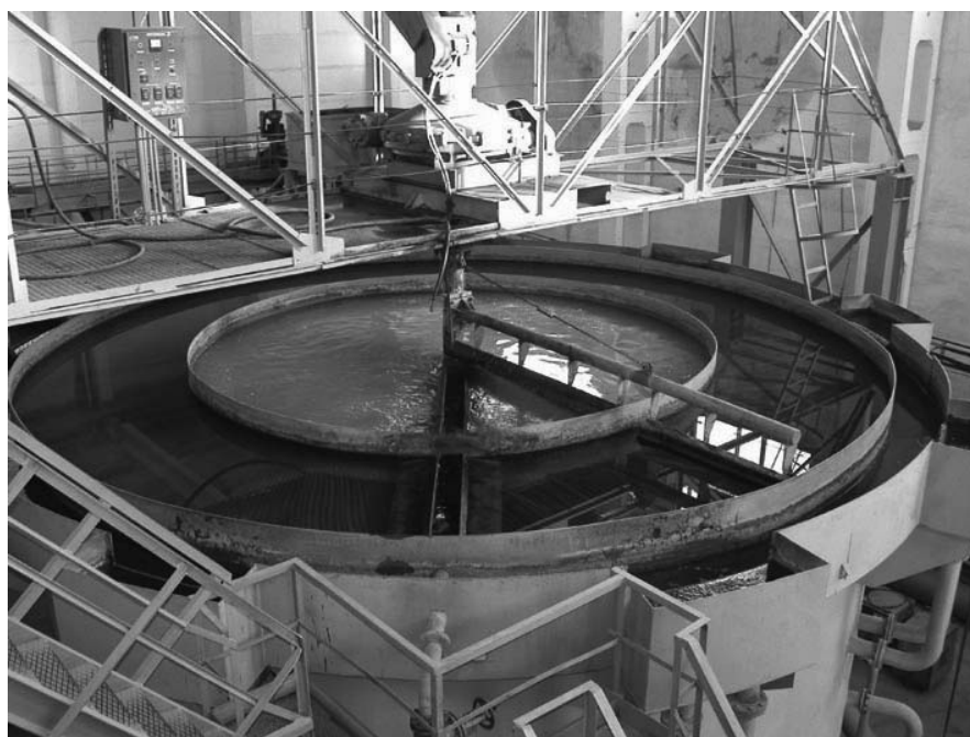
Рис. 2. Отстойник-флокулятор – 1-я ступень глубокой очистки промышленно-ливневых сточных вод
