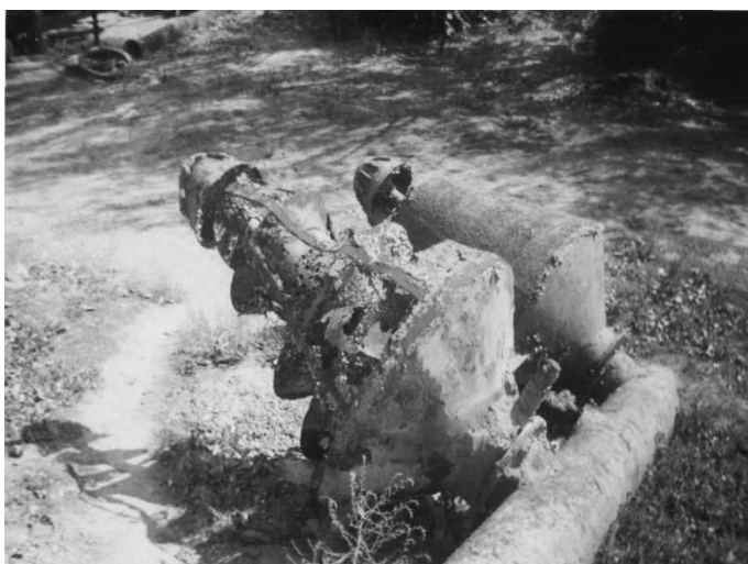
Рис. 1. Эксплуатация водоприемного устройства
