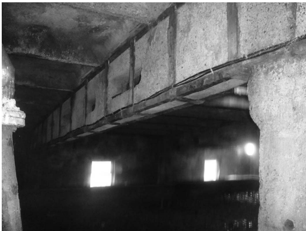
Рис. 1. Коррозионное разрушение несущих железобетонных конструкций покрытия
