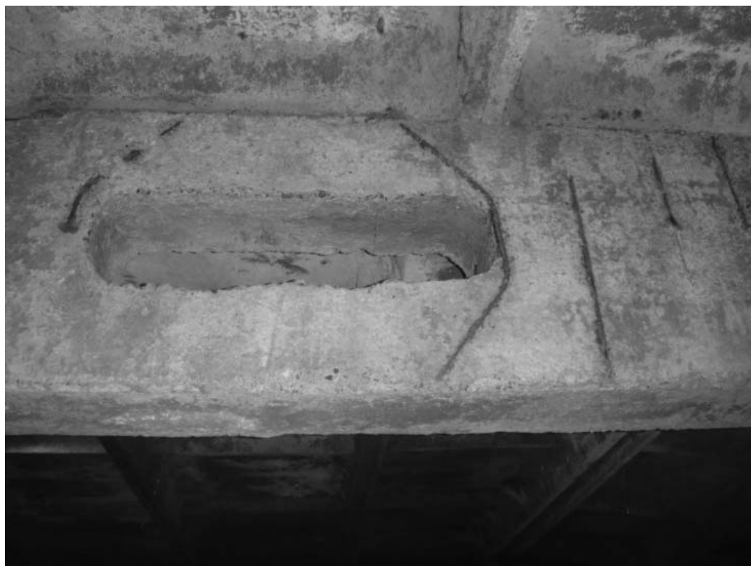
Рис. 2. Оголение арматуры в решетчатых балках покрытия
