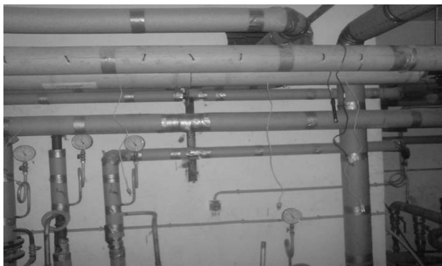
Рис. 2. Автоматизированный тепловой узел жилого дома
