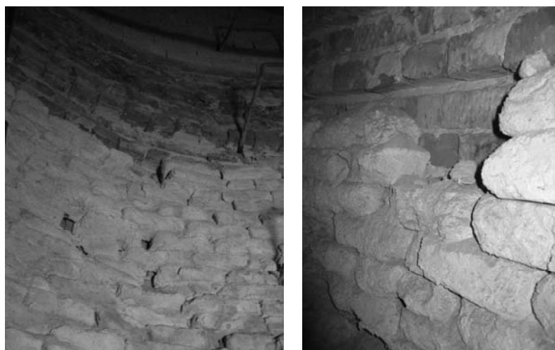
Рис. 3. Состояние футеровки, выявленное визуально
