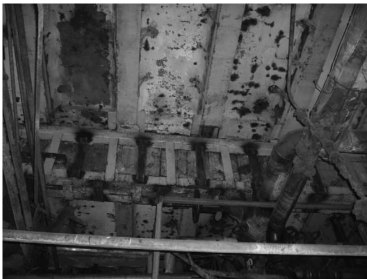
Рис. 2. Коррозионное повреждение балок, плит покрытия и металла усиления
