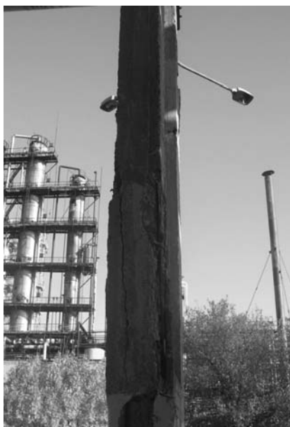
Рис. 1. Коррозионное повреждение железобетонной опоры
