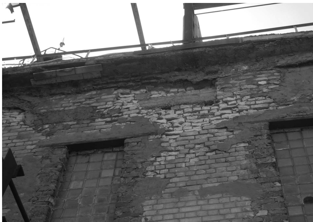
Фото 1. Разрушение кирпичной кладки стены на глубину до 200 мм из-за нарушения отвода воды с кровли
