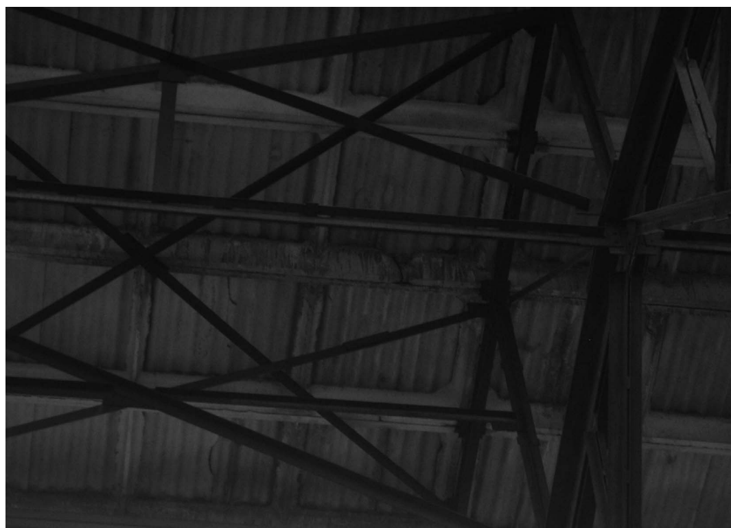
Фото 3. Разрушение продольного ребра и коррозия рабочей арматуры плиты покрытия
