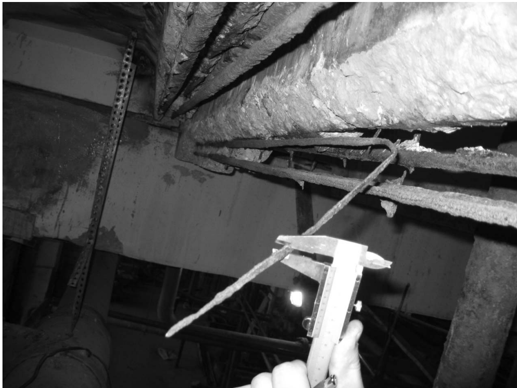
Фото 5. Разрушение защитного слоя бетона, коррозия и обрыв рабочей арматуры продольных ребер плит перекрытия
