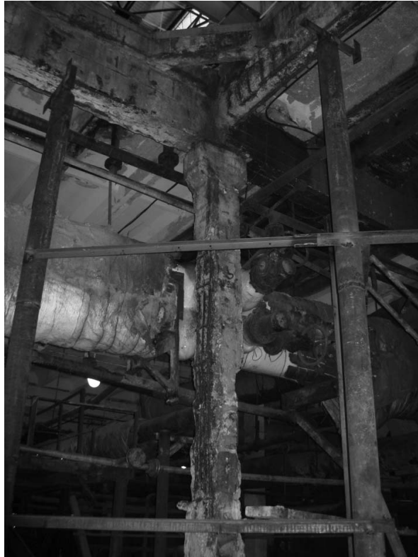
Фото 4. Значительные коррозионные повреждения колонны и плиты под полимеризатор из-за воздействия агрессивной среды
