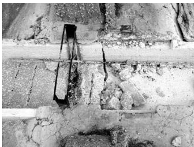
Рис. 10. Повреждение стыка лотков и коррозия рамки аварийного затвора
