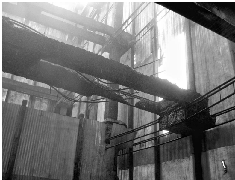
Рис. 4. Повреждения балок каркаса градирни
