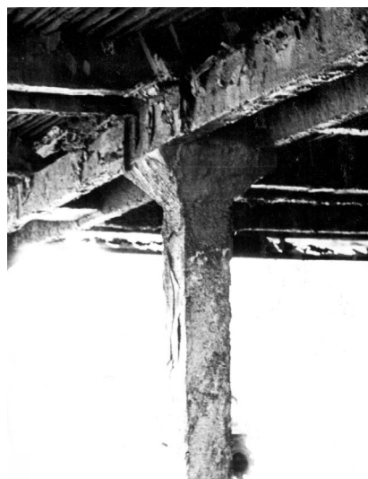
Рис. 3. Повреждения стойки каркаса градирни
