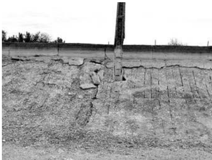
Рис. 7. Эрозия наружного слоя бетона
