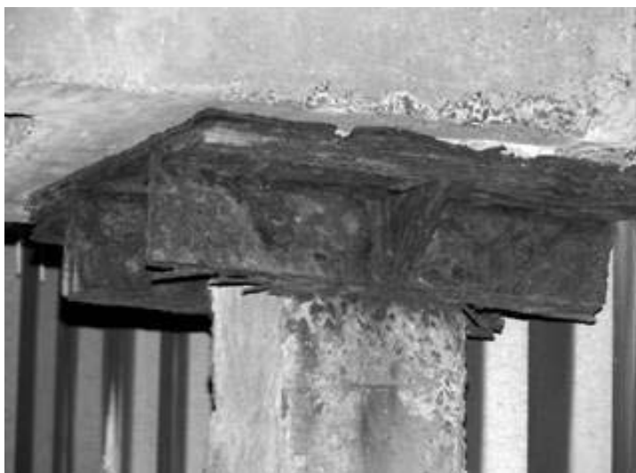
Рис. 2. Поврежденная закладная деталь градирни
