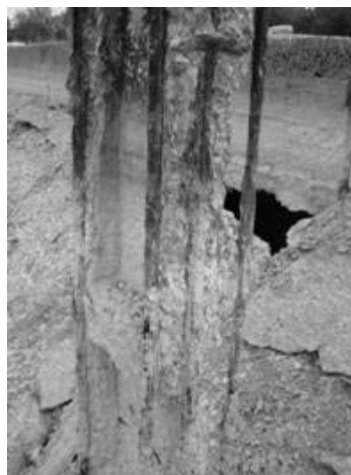
Рис. 8. Провалы бетонного покрытия
