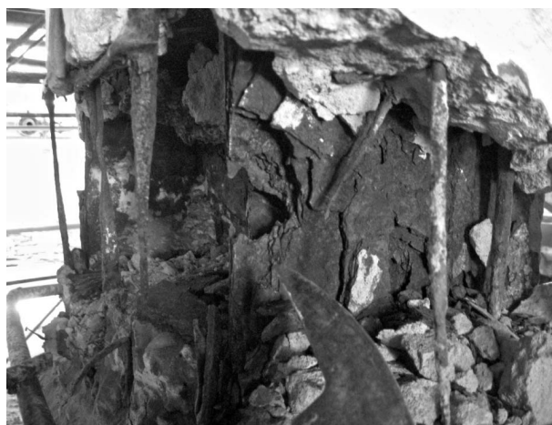
Рис. 4. То же, сквозное повреждение полки колонны слоистой коррозией
