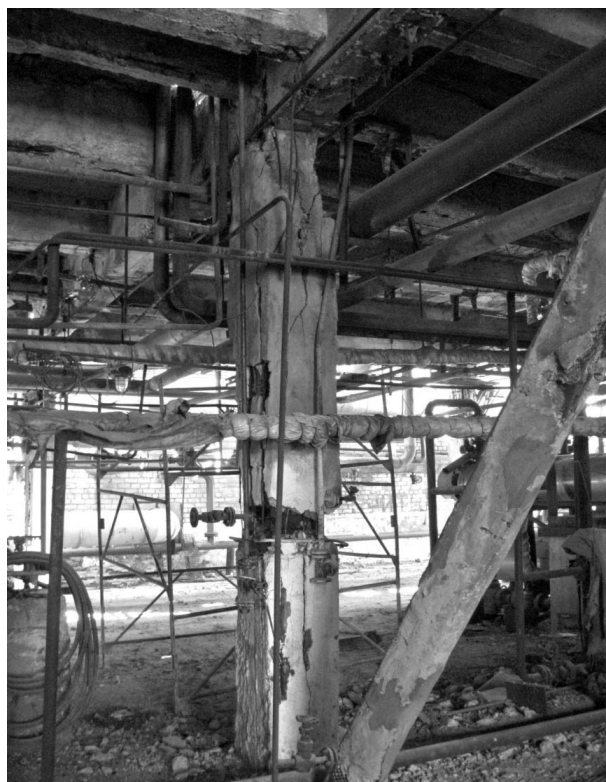
Рис. 3. Общий вид аварийной колонны 10-Н, трещины в обетонке
