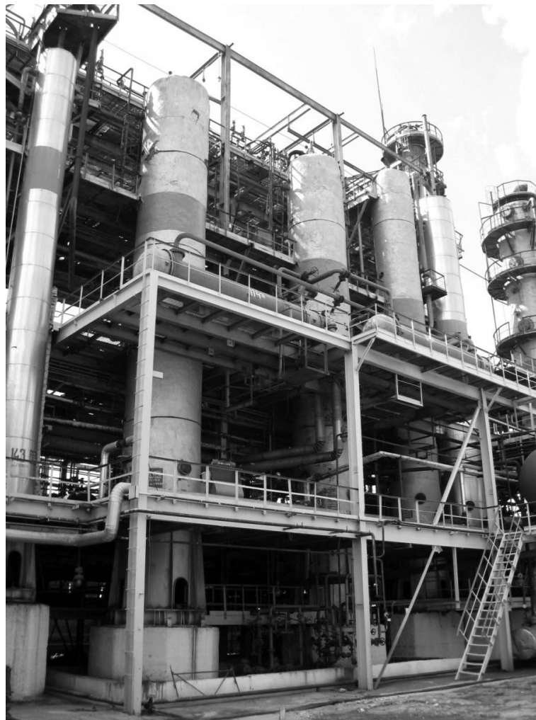
Рис. 1. Общий вид наружной установки
