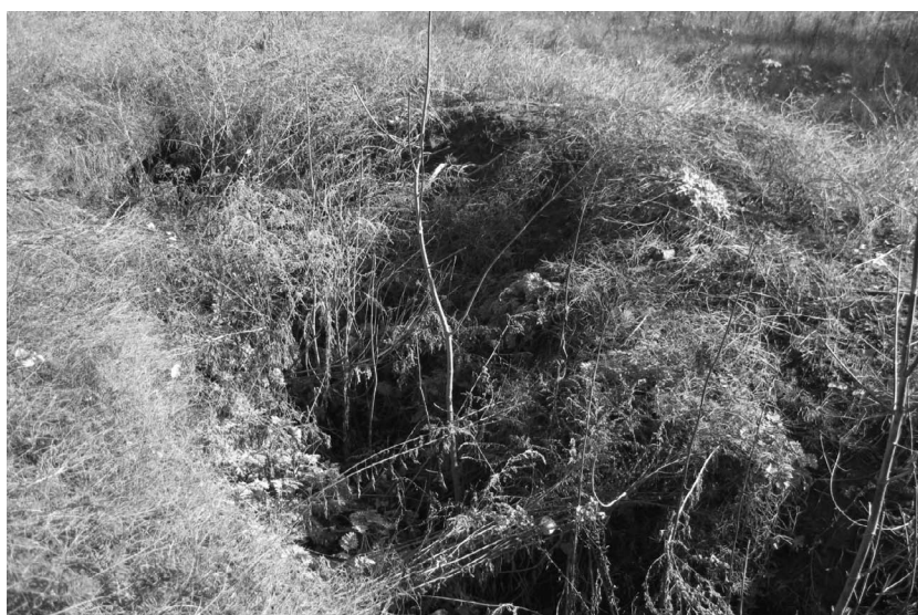
Рис. 2. Фильтрационные деформации на низовом откосе плотины
