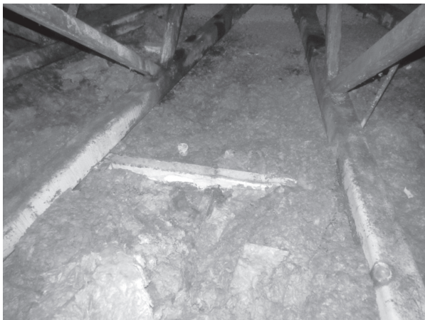
Рис. 2. Коррозия несущих элементов подвесного чердачного перекрытия над помещением сушильной камеры на участках их сопряжения между собой при помощи сварных швов
