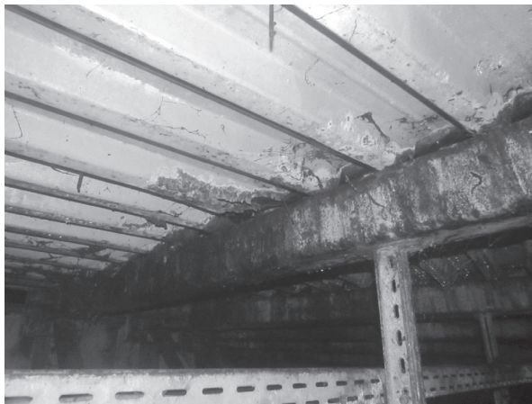
Рис. 4. Сквозная коррозия локальными участками профилированного настила покрытия над помещением сушильной камеры
