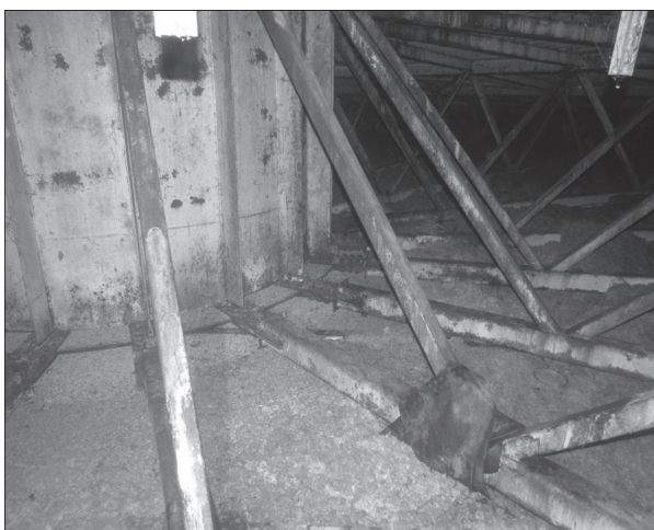
Рис. 3. Поверхностная коррозия элементов стропильных конструкций покрытия
