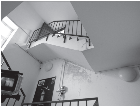
Рис. 5. Сухие следы увлажнения поверхностей стен помещения встроенной лестницы вследствие нарушения его температурно-влажностного режима в холодный период года
