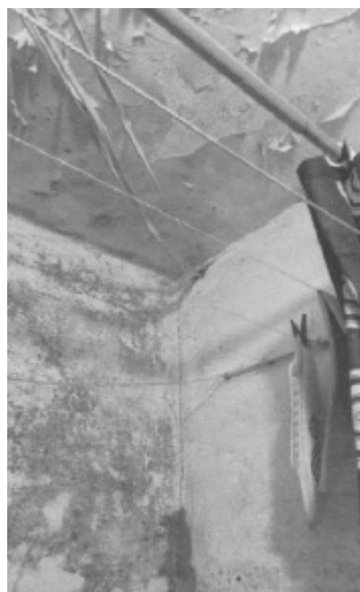
Рис. 2. Осыпания на потолке и темные пятна по наружной стене в ванной комнате квартиры в Советском районе
