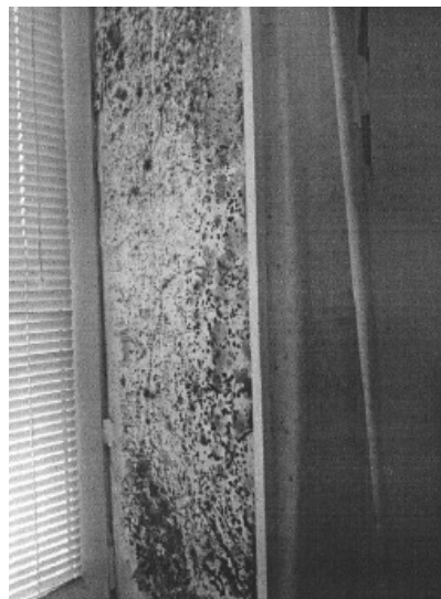
Рис. 1. Оконный откос квартиры в Промышленном районе Fig. 1. Window slope of an apartment in the Industrial District
