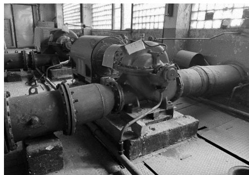
Рис. 2. Насосные агрегаты станции мелиорации НСП «Заря Поволжья» до реконструкции Fig. 2. Pump units of the reclamation station NSP Zarya Povolzhye before reconstruction
