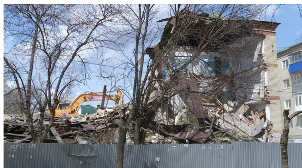
Рис. 2. Аварийный дом на ул. Ударной, 35
