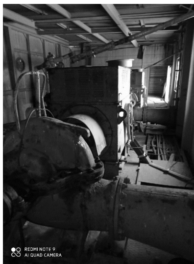
Рис. 4. Насосные агрегаты станции НС-42п Приволжской оросительной системы до реконструкции
