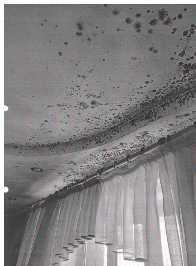
Рис. 5. Поражения на потолке квартиры в Октябрьском районе Fig. 5. Defeats on the ceiling of an apartment in the Oktyabrsky district
