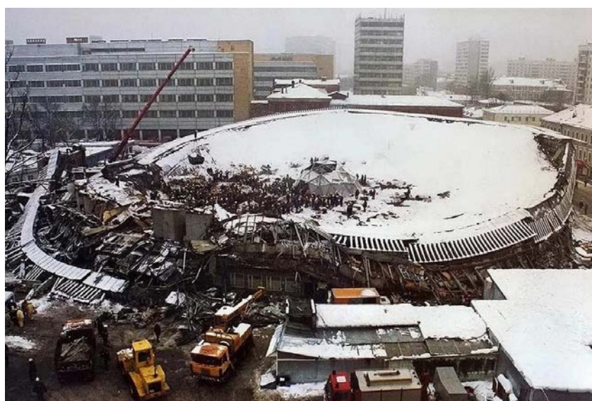
Рис. 1. Обрушение покрытия Басманного рынка (Москва, 2006)
