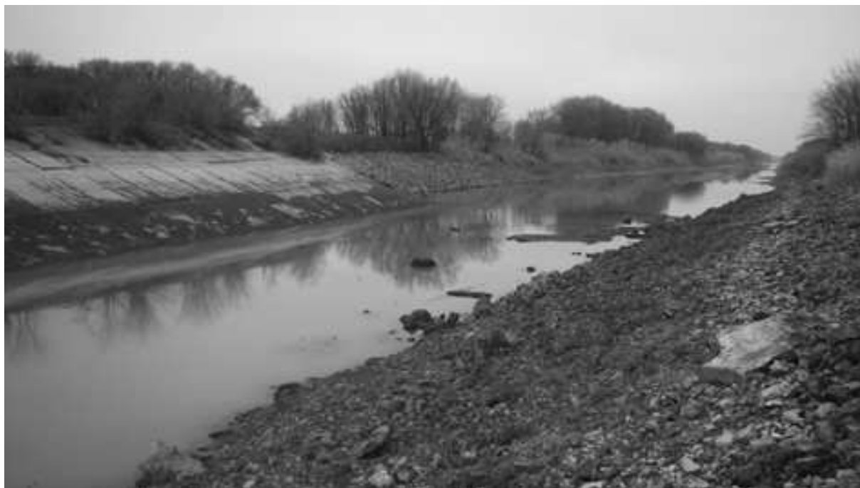
Рис. 2. Участок Донского магистрального канала до проведения реконструкции (дата проведения обследований – 08.12.2006 г.)
