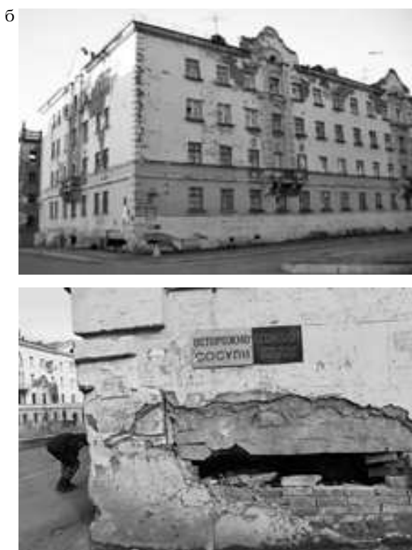
Рис. 4. Разрушение конструкций зданий в Норильске: а – здание по ул. Комсомольской, 1 [21]; б – здание на улице Богдана Хмельницкого, 14 [22]
