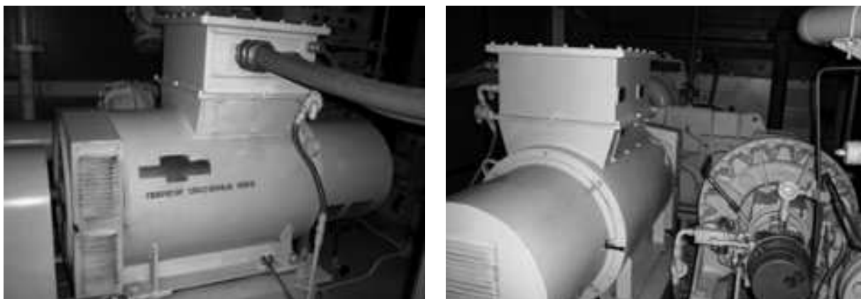
Рис.1. Внешний вид генератора собственных нужд агрегата ГТК-10И
