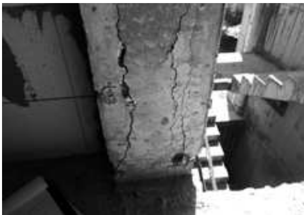
Рис. 4. Вид коррозионного разрушения бетона стены второго этажа по оси 3 продуктами коррозии арматурных стержней незавершенного строительством здания
