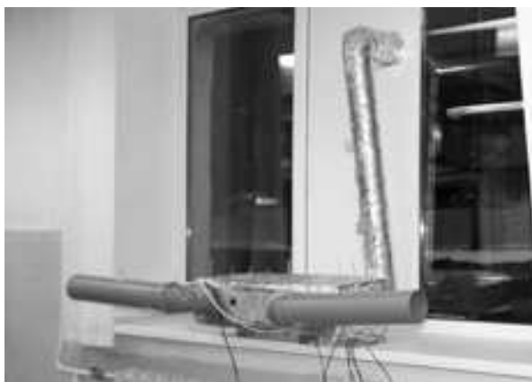
Рис. 6. Вентиляционная установка, смонтированная и оборудованная для проведения натуральных испытаний
