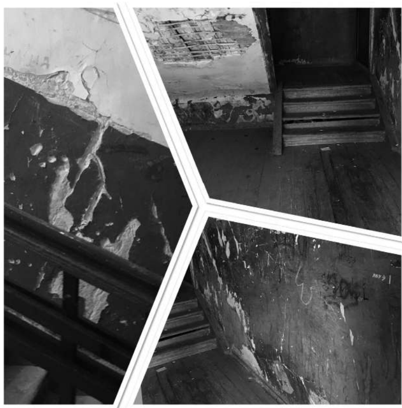
Рис. 6. Состояние оснащения подъезда аварийного здания
