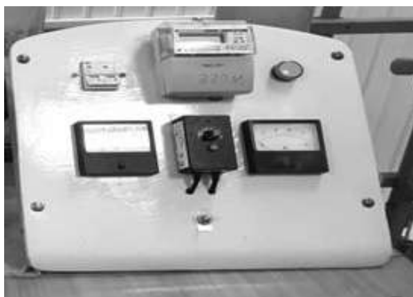
Рис. 4. Электрическая панель установки МПВБ
