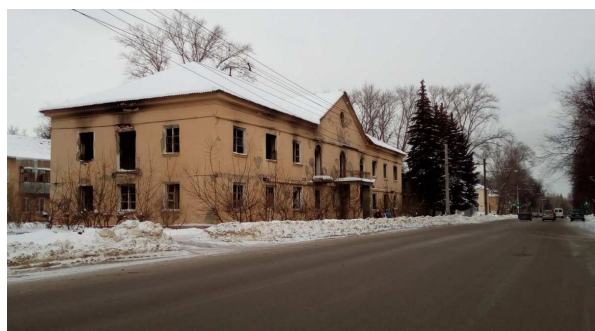
Рис. 4. Аварийный дом на ул. Леонова, 13
