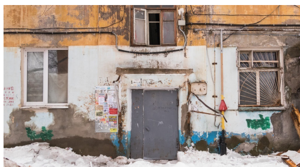
Рис. 3. Аварийный дом на ул. Циолковского, 14
