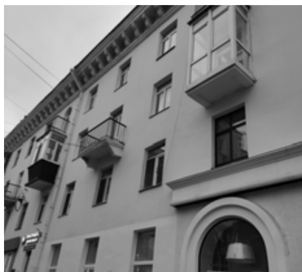
Рис. 2. Под частью балконов отсутствуют декоративные консоли
