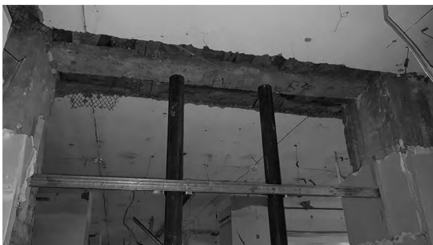
Рис. 6. Испытание № 1. Вид на нижнюю поверхность перекрытия и балки
