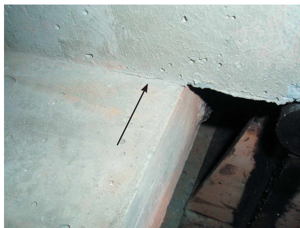
Рис. 6. Трещина вдоль пролета в месте примыкания полки
