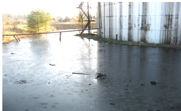
Рис. 1. Утечки мазута из емкостей котельной п. Кедровый Красноярского края
