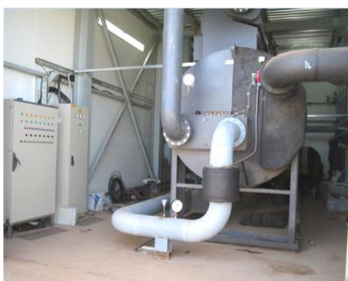
Рис. 7. Установка утилизации тепла отходящих газов
