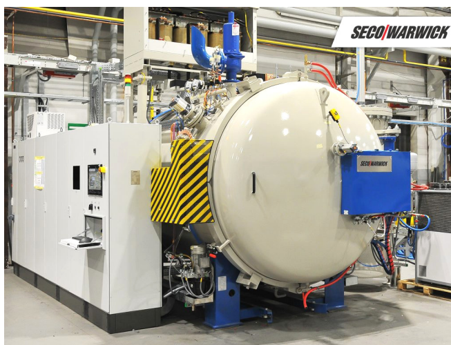
Рис. 3. Вакуумная печь SECO/WARWICK 10 VPT-4050/48 HV
