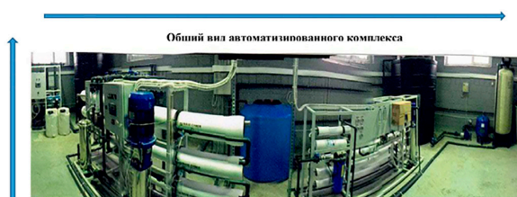
Рис. 2. Общий вид автоматизированного комплекса очистки сточных вод Fig. 2. General view of the automated wastewater treatment facility
